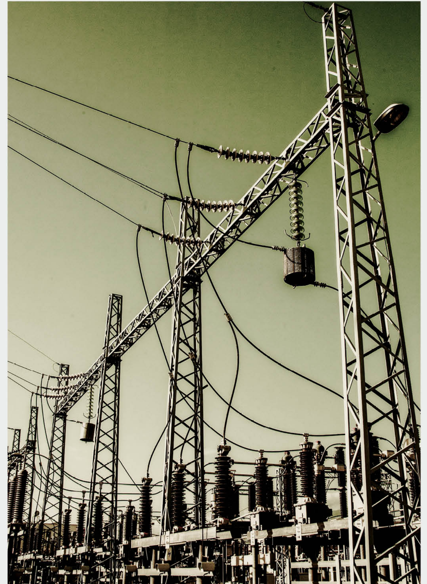
Linjë 110 kV ku është instaluar OPGW
