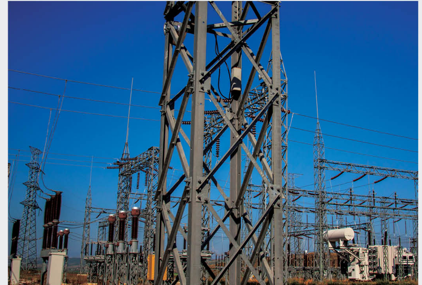
Zgjerim i nënstacionit Babicë
