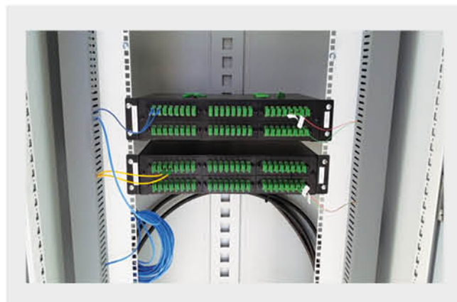
Terminale ODF të OPGW.
