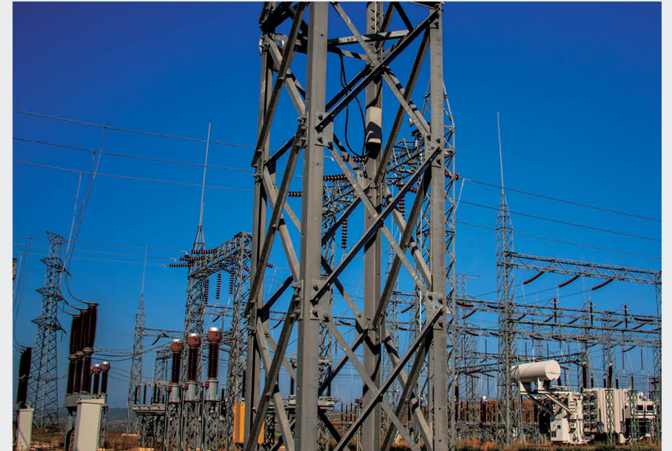
Zgjerim i nënstacionit Babicë
