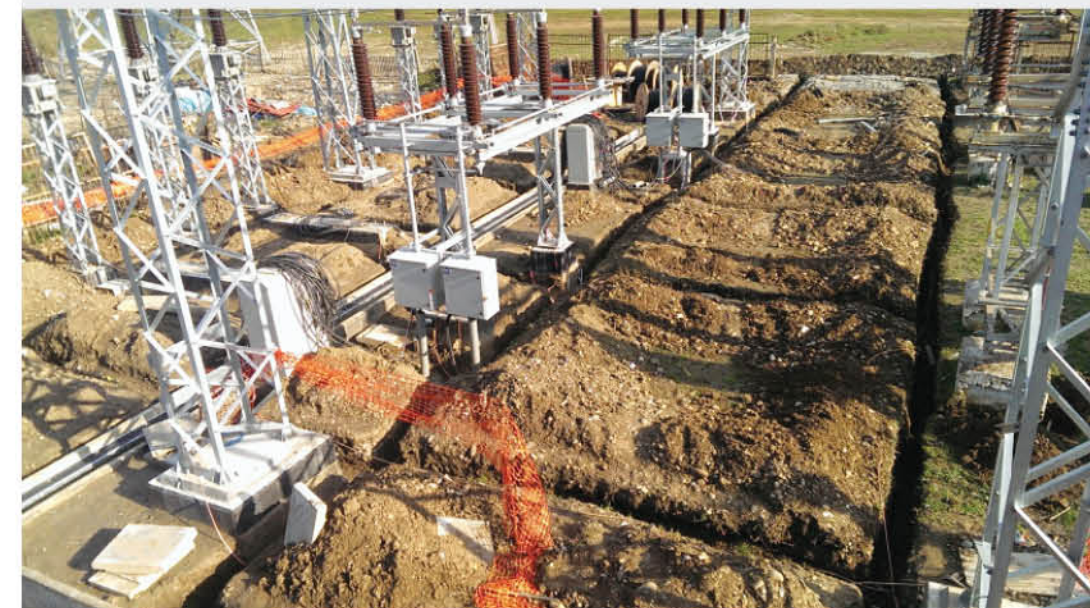
Sistemi i tokëzimit në nënstacionin Përmet
