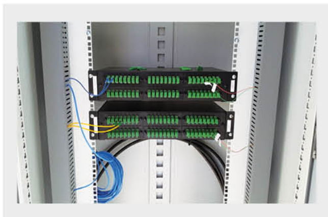
Terminale ODF të OPGW.
