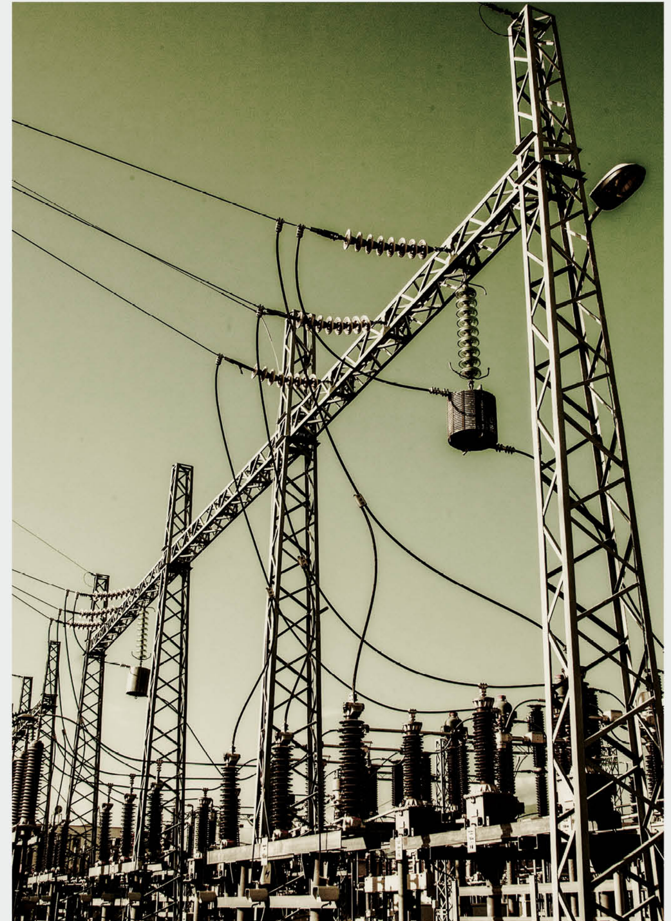
Linjë 110 kV ku është instaluar OPGW
